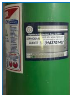
“Registro fotográfico de extintor con fecha de vencimiento enero de 2026, observado durante recorrido de verificación”
