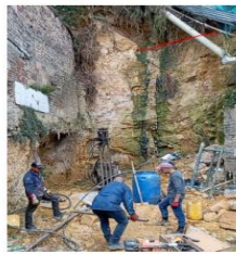
Fotografía #. 3. Evidencia de flujo de agua en el talud principal. Fuente: Autores.
