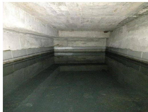
Tanque de almacenamiento aguas lluvia.
