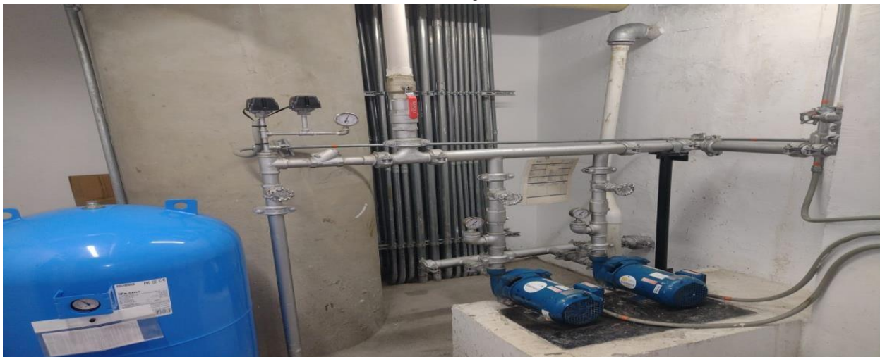
Sistema de bombeo aguas lluvia.
