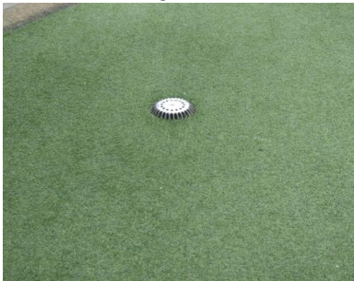
Sumideros recolección aguas lluvia
