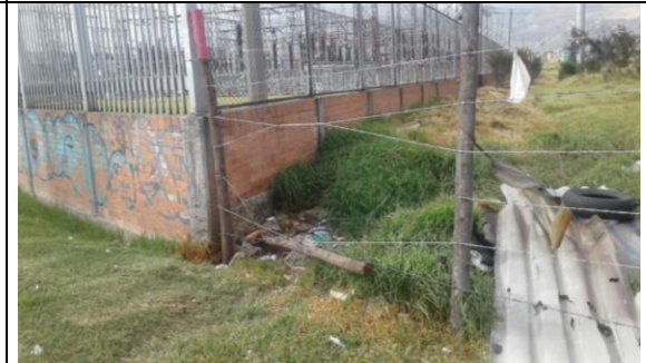
Imagen N°4. Daños al cerramiento.
