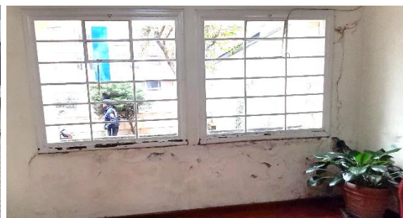
Fotografía 4. Muros con problemas estructurales y de
